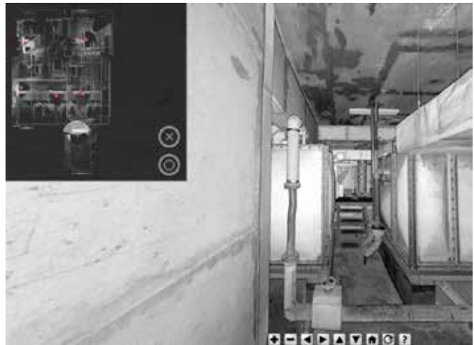
포인트 클라우드 데이터로 생성한 파노라마 보기 - 왼쪽 상단의 2D 설계도에서 360° 보기를 선택할 수 있습니다.
